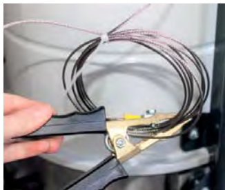
Liaison équipotentielle et mise à la terre
