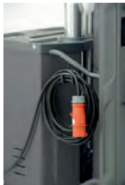
Rangement pour le câble électrique
