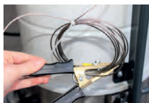
Liaison équipotentielle et mise à la terre
